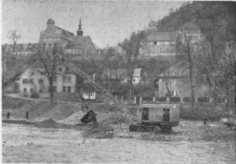
V ponedeljek je velik bager še »na vso sapo« zajemal rečni prod iz Savinje pred parkom, kjer se je te dni začela sedma etapa regulacije Savinje. Sneg, ki je v tork zametel delovišče, je prisilil bager na umik na skrajni rob struge.
