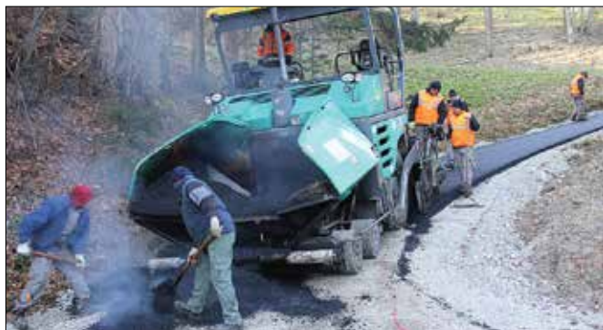
Asfaltiranje odseka ceste, ki vodi proti domačiji Martk v Raduhi. (Fotodokumentacija Občine Luče)
