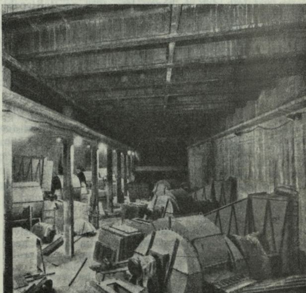
Centrala za ventilacijo
