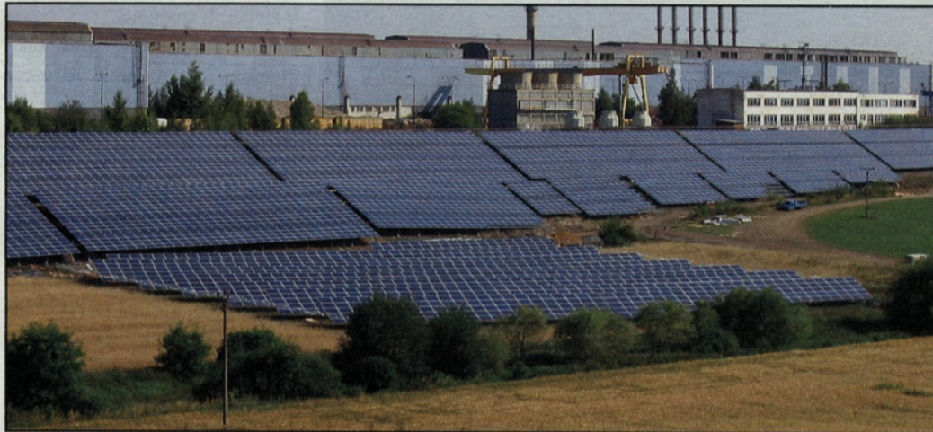
Nova sončna elektrarna v Buštehradu
