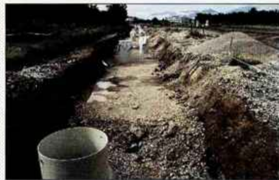
Gradnjo komunalne infrastrukture v Obrtni coni Trata je težko pričakalo nekaj zasebnikov, ki bodo že kmalu začeli z gradnjo svojih prostorov. / Foto: Gorazd Kavčič
