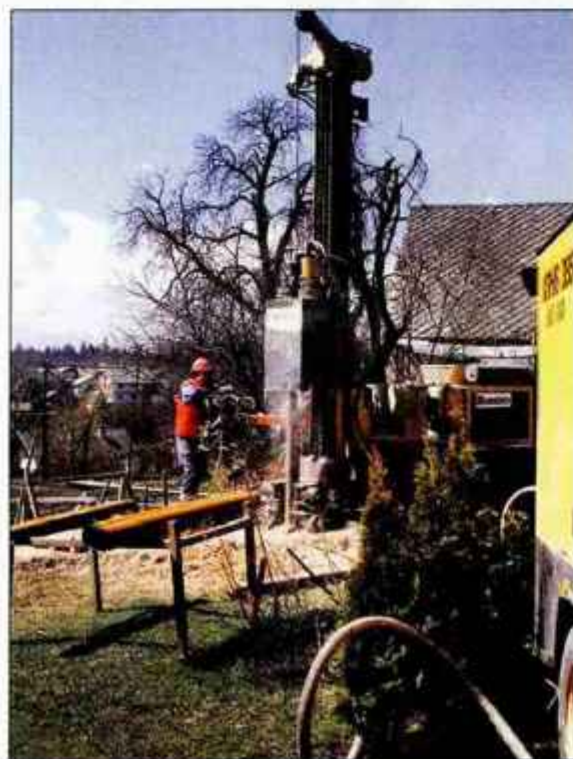
Vrtanje vrtine je za Geosondo eden od najzahtevnejših postopkov pri pripravi na izkoriščanje geotermalne energije. Od sestave tal je odvisna potrebna globina vrtine in učinkovitost sistema.
