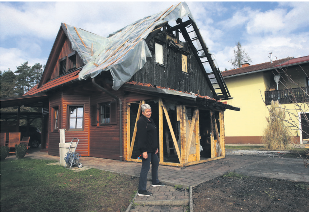
Požar je hišo koncev Jamnikar povsem uničil. Kot je povedala Zdenka, bo treba zgornji del v celoti podreti, medtem ko bodo skušali ohraniti in obnoviti pritličje.
