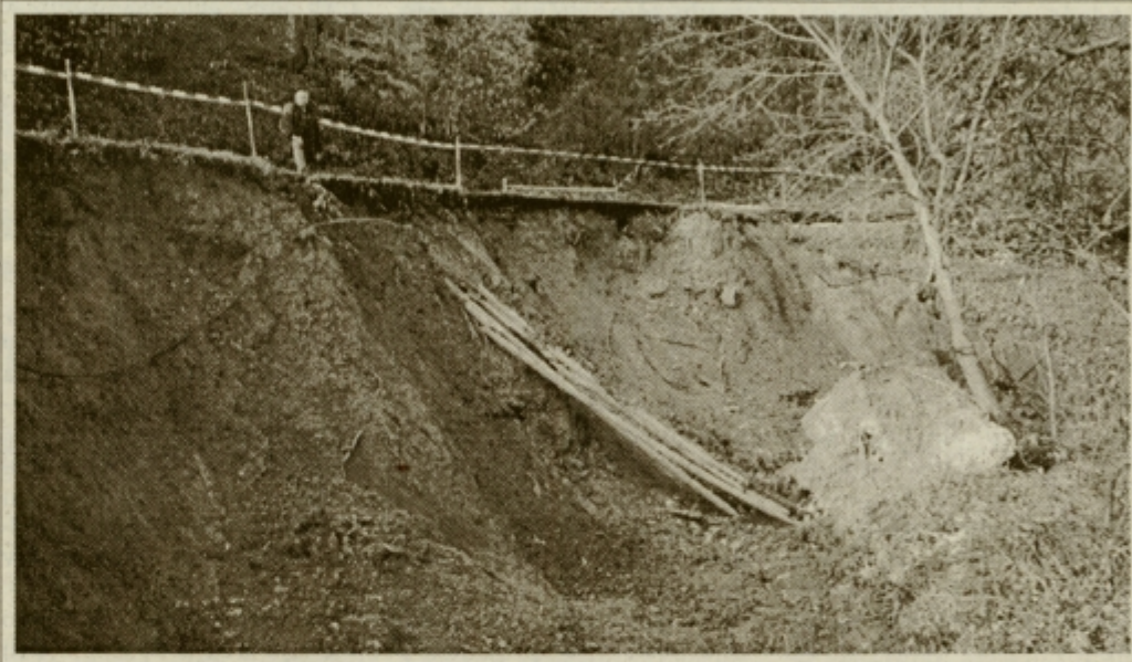
Zemeljski plaz je odnesel telefonsko kabelsko napeljavo.
