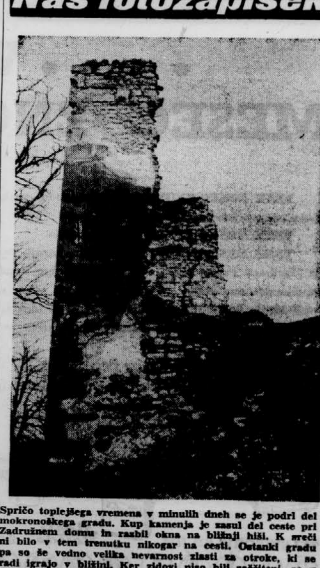
Spričo toplejšega vremena v minulnih dneh se je podrl del monokromnega grada. Kup kamena je zasul del ceste pri Zadrženem domu in rasli obok na bližnji hrib. K reči ni bilo v tem trenutku nikogar na cesti. Ostanki grada pa so še vedno velika nevarnost zlasti za otroke, ki se radi igrajo v bližini. Ker zidovi niso bili zakriti, so v tako slabem stanju, da so stalna nevarnost za okolico. Ne kaže drugega, kot jih podrli. Foto: F. Romančič
