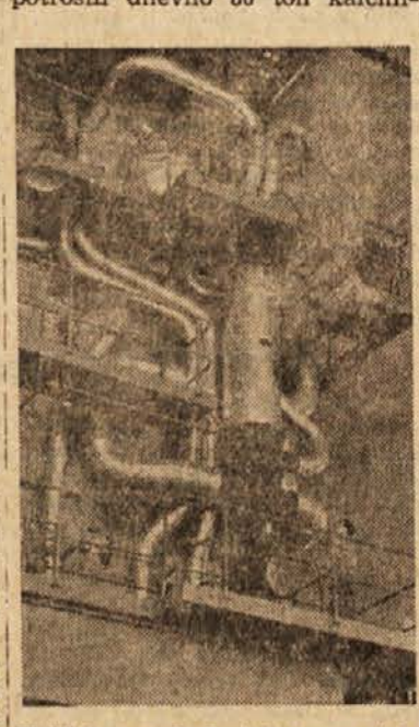
Veliki parni kotel energetske centralne daje 50 ton pare na uro
