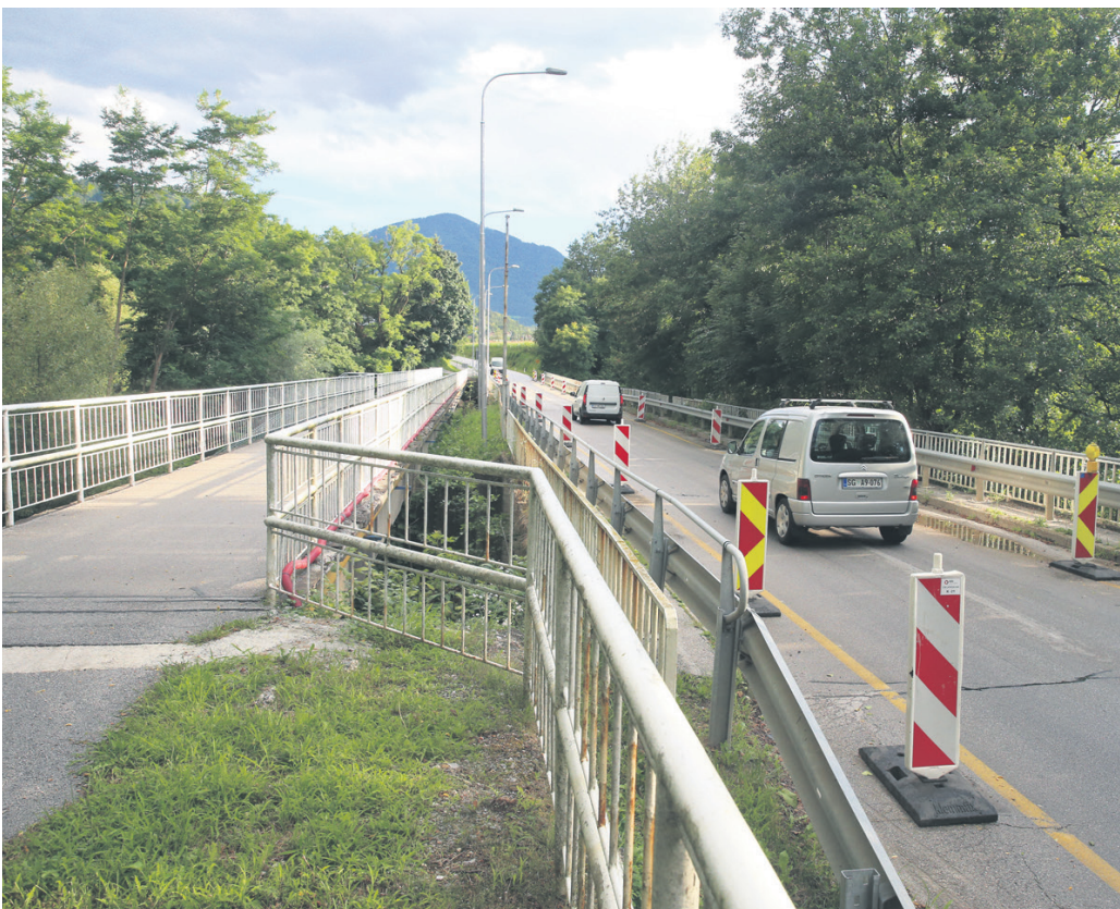
V občini pravijo, da tako cestnega kot kolesarskega mostu ni smiselno obnavljati, pri čemer načrtujejo, da bodo lahko že prihodnje leto začeli graditi novega.
