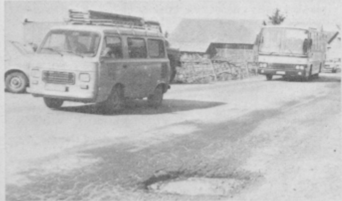
Del močno poškodovane magistralne ceste Ptuj—Ormož pri križišču v Spuhlji (foto: M. Ozmeč)
