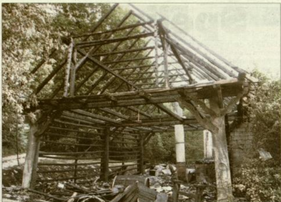
Požar na 110 let starem kozolcu na Pepelnem 1, ki je bil podtaknjen v nedeljo zvečer, je omejilo in pogasilo 28 gasilcev PGD Šmartno v Rožni dolini, PGD Ostrožno in poklicne enote PGE Celje. Požar se ni razširil na bližnjo hišo, škode pa je za okoli tri milijone tolarjev.
