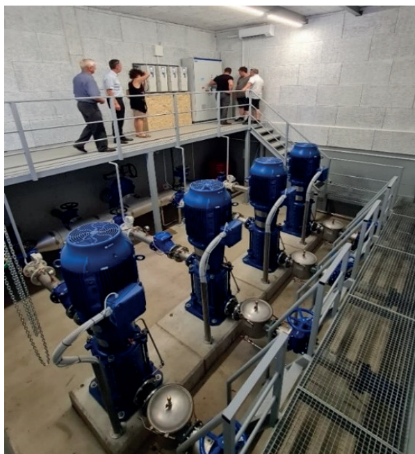
Posodobljeno črpališče z novimi črpalkami (Foto: B. Naglič)
