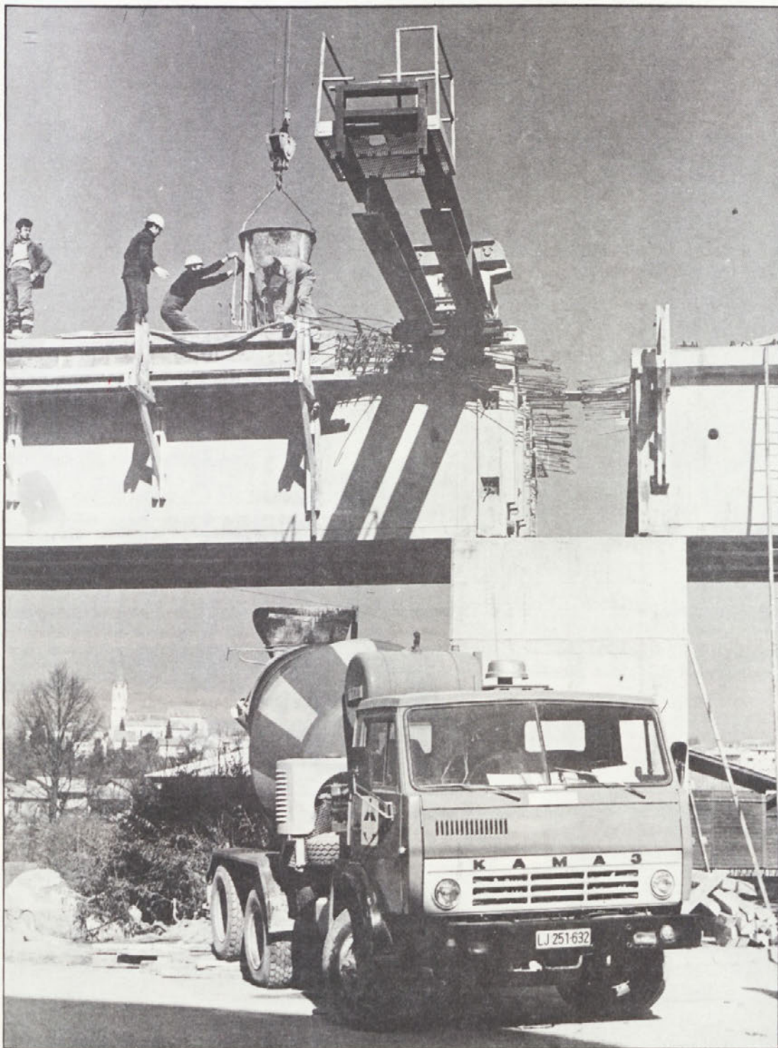
Simfonija dela – viadukt industrijskega tira Kandija-IMV med gradnjo. Globoko temeljenje je bilo ponekod potrebno zaradi posebnih zahtev terena, a vsi naporji so premagani: te dni pripelje prvokrat na „naše dvorišče“ zeleni vlak, bodoča hitra povezava Novega mesta z Ljubljano (Foto: M. Zaplatil).
