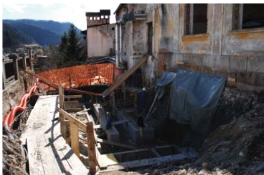
Večina instalacij, nujnih za brezhibno obratovanje dvorane, je skritih pod zemljo.
