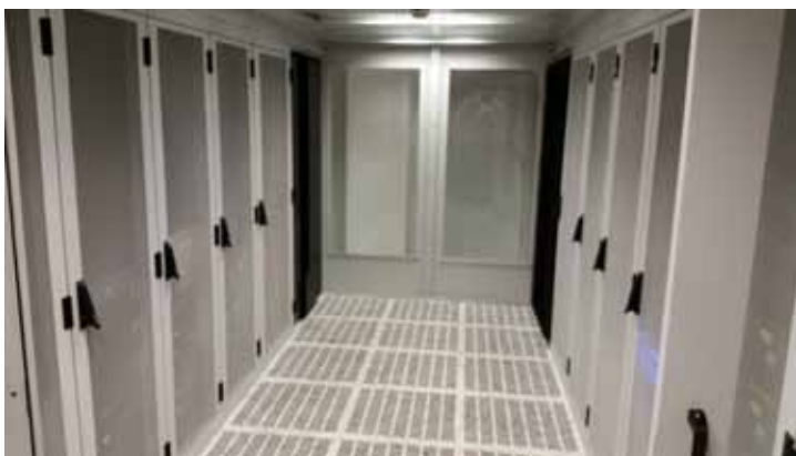
Varni podatkovni center SURS-a – strežniška soba
