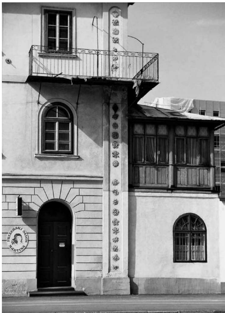
Slika 3: Zahodni del severnega pročelja – vogalna lizena z nizom rozet in lesena veranda
