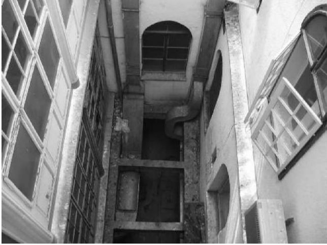
Slika 1: Severni del svetlobnika - pogled od zgoraj
