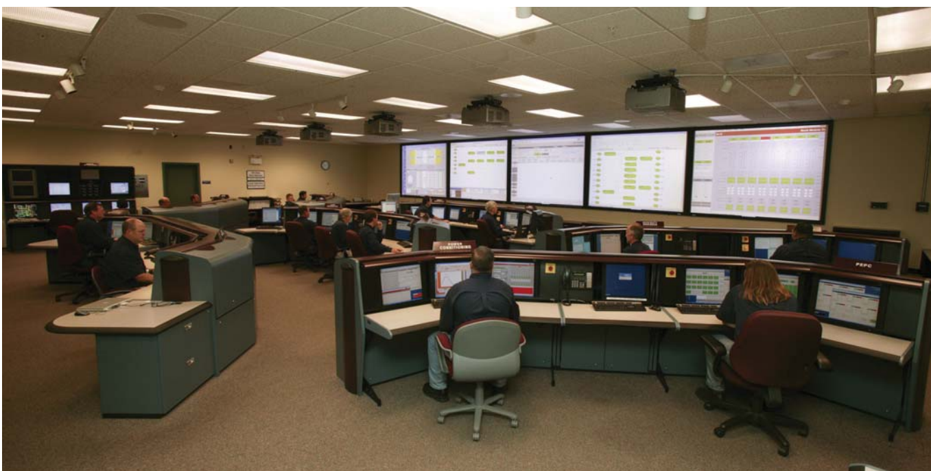
Kompleksno upravljanje dovršene opreme in procesov: kontrolna soba NIF
