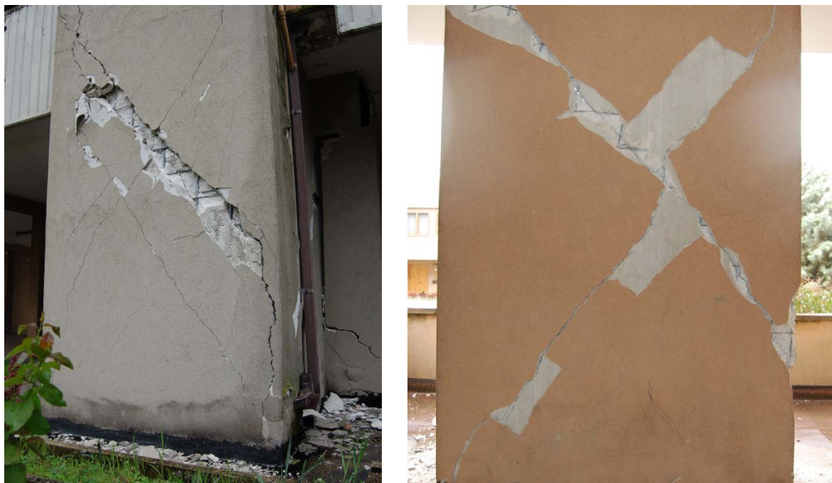
Slika 3.32: Poškodbe na stenah stanovanjske zgradbe v L'Aquila (Italija) po potresu leta 2009
