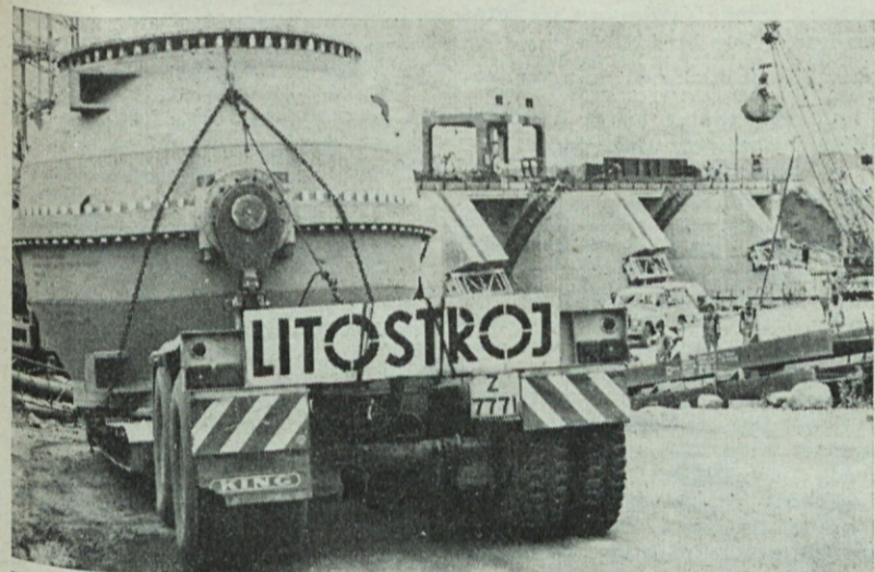
Transport krogličnega zasuna prek reke Tane. Most, ki tu vodi čez reko, je poleg jezja, v katerega vgrajujejo segmentne zapornice, ki jih je izdelala Metalna iz Maribora (Foto inž. Stokelj)
