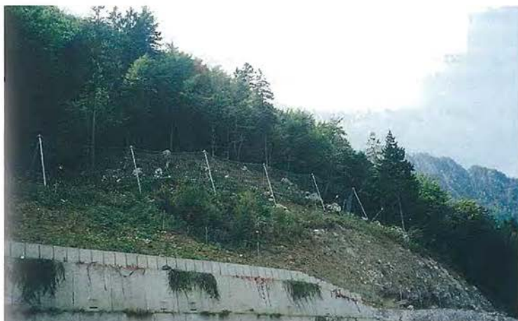
Slika 1: Zaščitni ukrepi pred padanjem skal ob AC Hrušica-Vrba: podajne lovinske ograje (Foto: D. Durjava)
