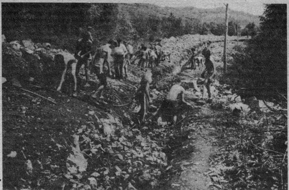
Mladina pomaga z delom povsod! Slika je z mladinske delovne akcije na Primorskem, kjer so gradili vodovod. Mladim čestitamo k njihovem kongresu!
