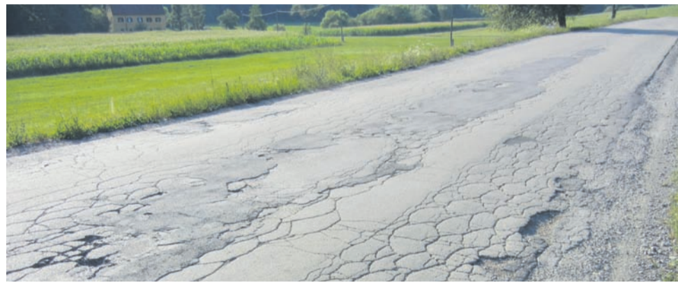
Državna cesta med Polzelo in Velenjem je bila pred nekaj leti po mnenju obiskovalcev spletne strani Avto magazin razglašena za najslabšo cesto v državi. Direkcija za infrastrukturo jo je začela obnavljati pred dvema letoma in bo nadaljevala tudi letos.
