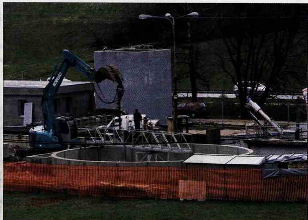
Izgradnja čistilne naprave na Dobni lepo napreduje, več težav imajo s pridobivanjem soglasij za kanalizacijo.
