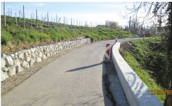
Sanacija plazov v Dravinjskem Vrhu
