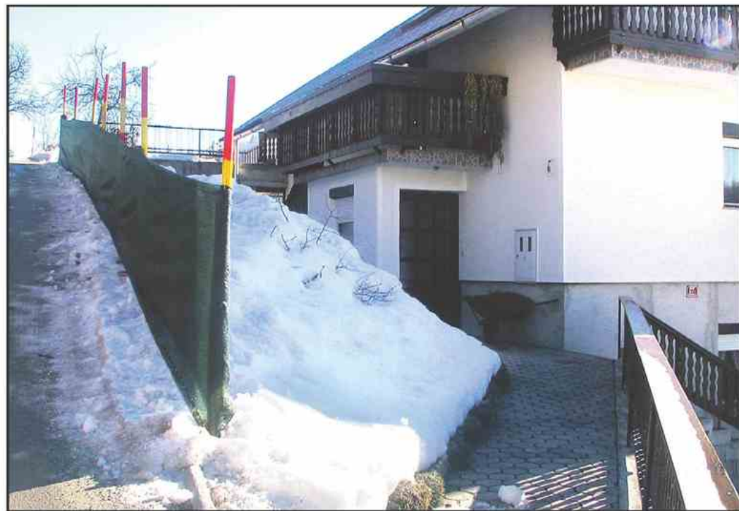
Hiša ni veliko oddaljena od ceste, pa še v hribu je. Da je škoda narejena tudi na fasadi, pa je vidno.
