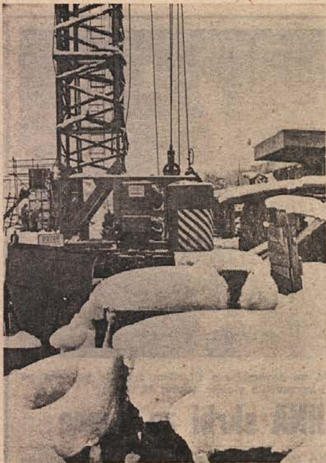
V Stari vasi pri Krškem gradi podjetje PIONIR novo pekarno. Investitor je ZITO iz Ljubljane. Snega se na gradbišču niso ustrašili. Delo bodo nadaljevali, dokler ne bo zmrzovalo. (Foto: Jožica Teppey)
