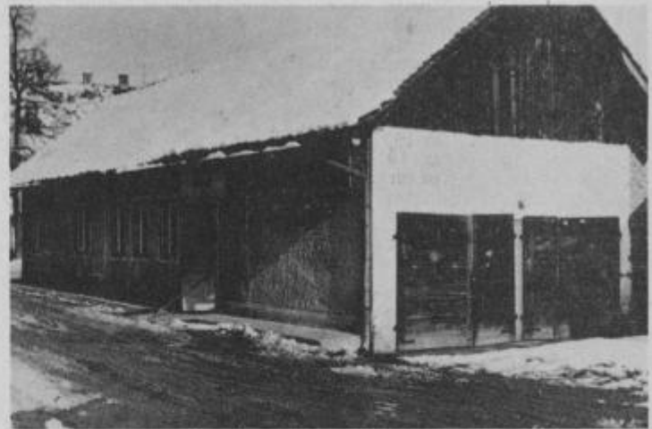
Sedanja zgradba veterinarske postaje Ormož pred razpadom.
