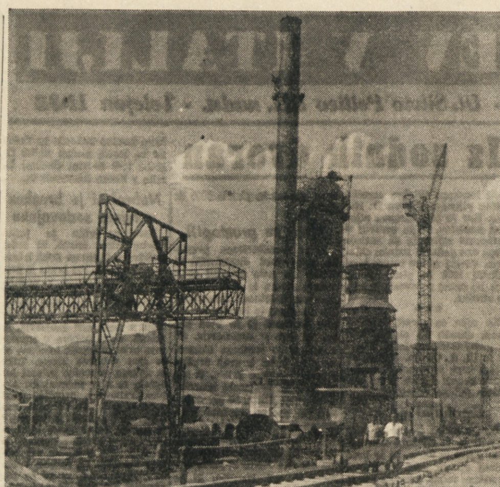
V Zenici, kjer gradijo največji metalurški kombinat v Jugoslaviji, so te dni zaključili montažo železne konstrukcije visoke peči. To je največja peč v državi in bo dnevno proizvajala 600 ton surovega železa — dvakrat več od dosedanjih proizvodov vseh peči v Jugoslaviji. To je prva od dveh visokih peči, ki jih bodo zgradili v Zenici. Stara železarna v Zenici dela dalje, a okrog nje rastejo iz zemlje: nova jeklarna, težka valjalna, kovačnica, omenjeni novi visoki peči, koksarna itd. Grade tudi železniško postajo in regulirajo reko Bosno. Za sedaj namreč porabi železarna toliko vode kakor glavno mesto Jugoslavije — Beograd
