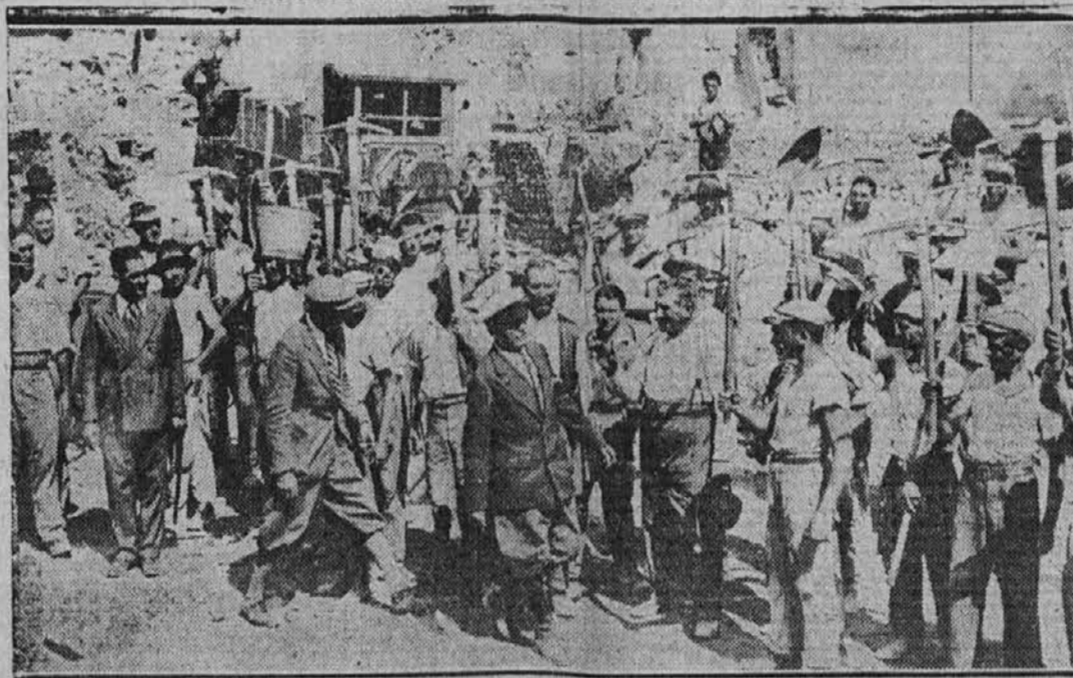
Na sliki se vidi italijanski diktator Mussolini (v sredi), ko je napravil inšpekcijsko potovanje po nekem starem delu mesta Rima, kjer delavci podirajo stara poslopja, da napravijo prostor za novo moderno cesto. Delavci so prekinili delo in dvignili krampe Mussoliniju v pozdrav.
