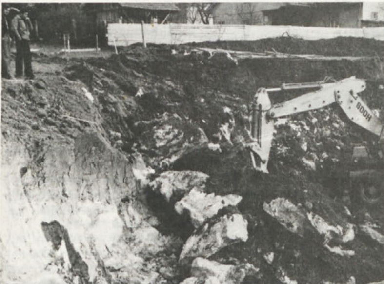
Tako je bilo ob začetku izkopa gradbene jame za centralno kuhinjo novomeških bolnišnic (Foto: MARJAN VENTA)
