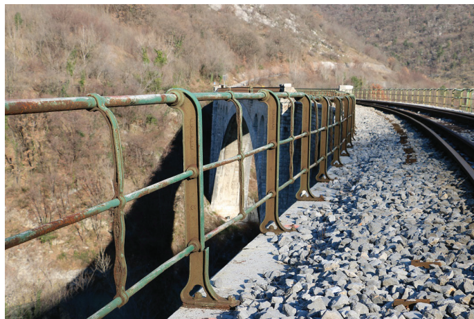
Slika 12. Enaka Wagnerjeva ograja, kot je nekoč stala na mostu v Ajbi, še danes stoji na Solkanskem železniškem mostu. Foto: Gorazd Humar, jan. 2022 [Humar, 2022].
