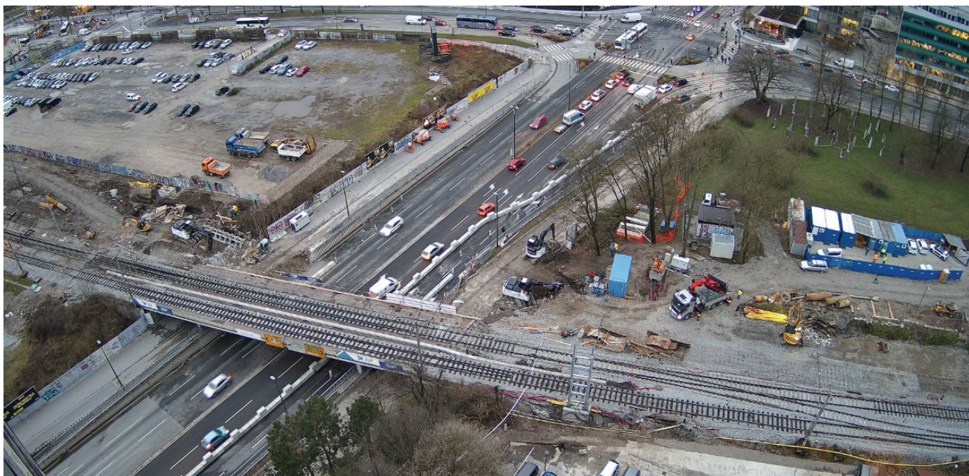
Slika 9. Pogled na ureditev železniškega in cestnega prometa v času gradnje južnega dela železniškega nadvoza čez Dunajsko cesto v Ljubljani.
