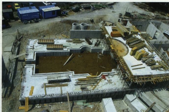
Slika 4 • Prva polovica termalnega bazena z izdelanimi odtočnimi kanali in ploščo ob bazenu
