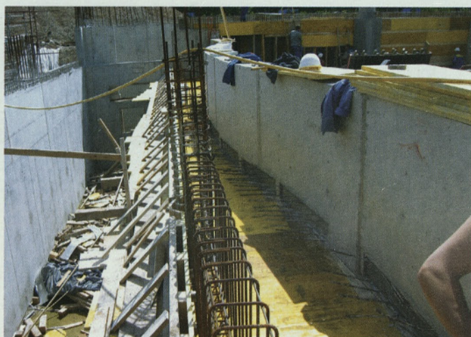
Slika 7 • Elementi Comax, pripravljene za povezavo z armaturo konzolne plošče kanala bazena z valovi
