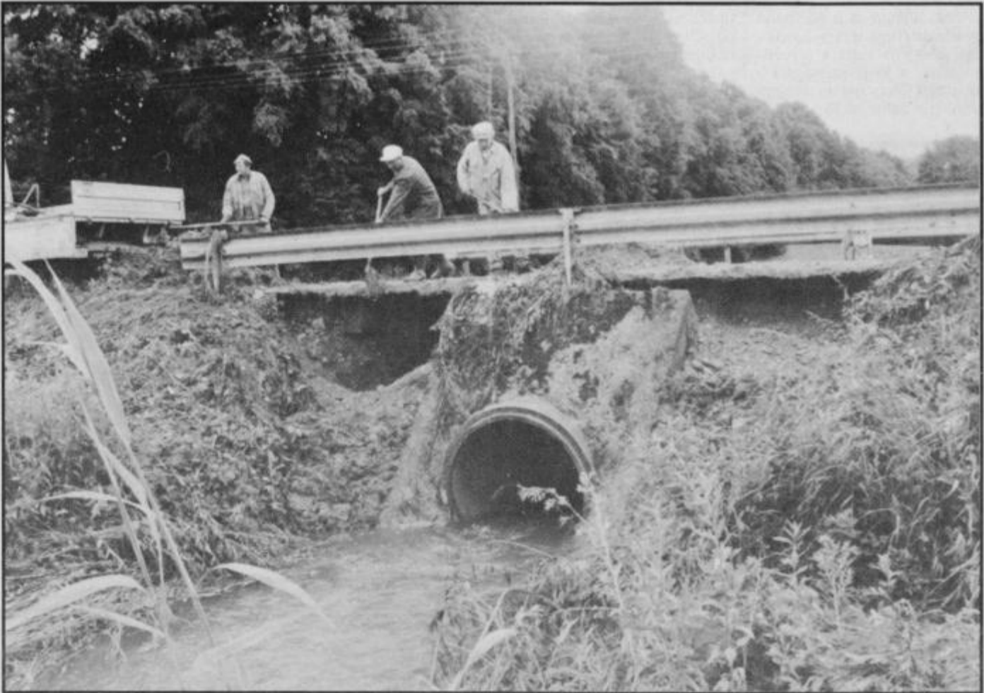
Delavcem Cestnega podjetja Ptuj je močan dež povzročil precej preglavic. Foto: Dušan Sterle
