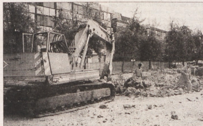
DELA PRI ZDRAVSTVENEM DOMU - Okoli novomeškega Zdravstvenega doma te dni potekajo obsežna dela. Urejajo parkirišča, pešpot in stopnice proti bolnici, kar bo veljalo okoli 25 milijonov tolarjev, hkrati pa gradijo še manjši prizidek, v katerem bo končno dobila primerne prostore fizioterapevtska dejavnost; to pa bo stalo blizu 30 milijonov tolarjev. Dela naj bi bila končana v oktobru. (Foto: A. B.)
