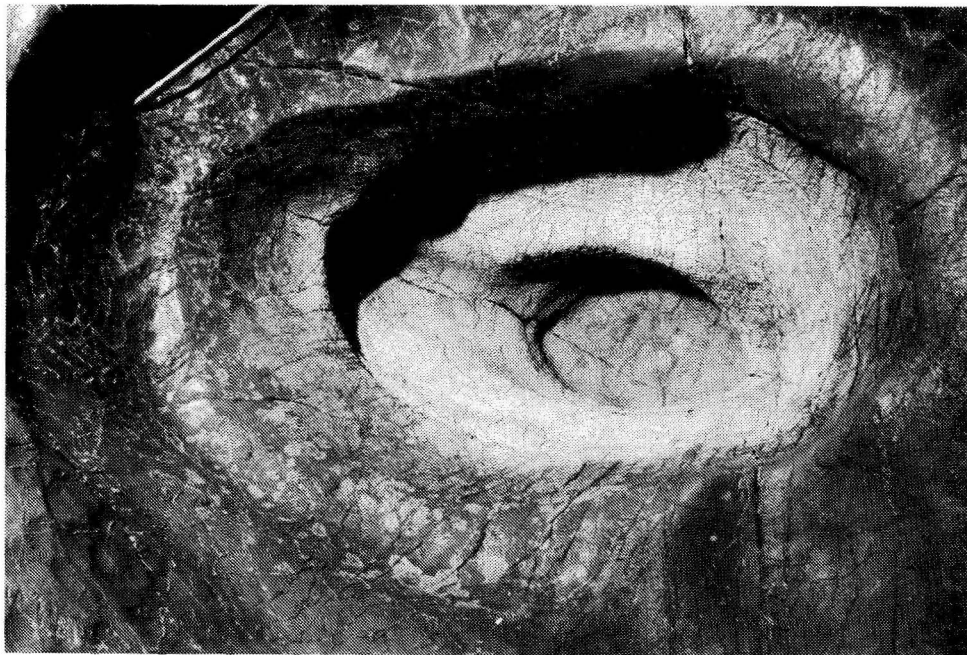
Sl.6 Kotlica v stropu vodnega rova (merilo je 0,15 metra)
