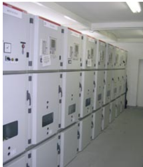
Novo stikališče 20 kV.
