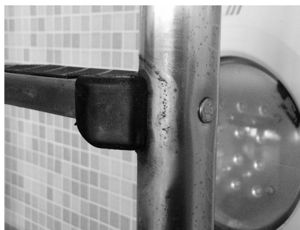
Figure 2: Rust on the vertical holder around the bolted-step connection Slika 2: Rja na vertikalnem nosilcu okrog vijačenega spoja stopnice
