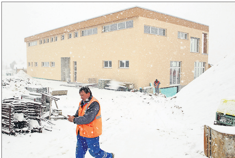
Večnamenska stavba na Destrniku že stoji, ali bodo v njej tudi občinski prostori, pa še ni znano.
