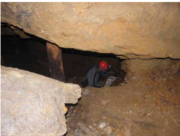
Sl. 4. Delno zarušen Janičekov rov. Vidne so subhorizontalne razpoke vzporedne starejšemu klivažu in strma prelomna površina (zgoraj). Levo spodaj je odlomljen blok brečiranega in nato še močno okremenjenega dolomita. Janičekov rov, opuščen rudnik Remšnik. Foto Z. Žorž.
