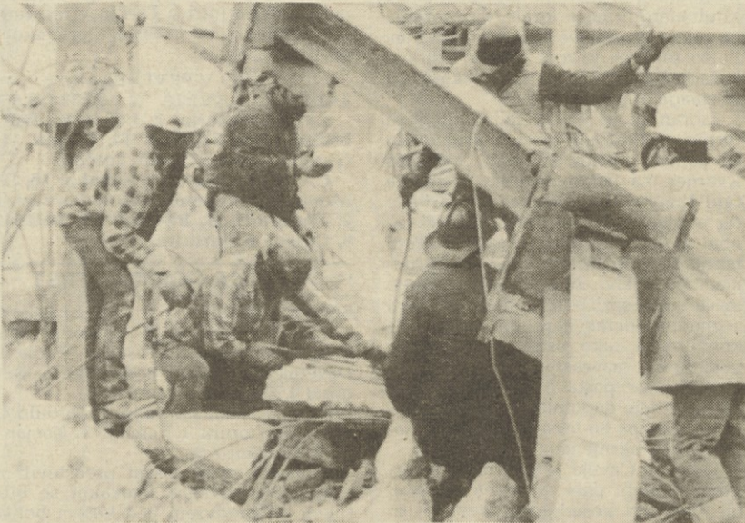
V Bridgeportu (Connecticut) se je na nekem gradbišču zrušila železobetonska plošča. V nesreči je izgubilo življenje 7 delavcev, na desetine jih je bilo hudo ranjenih, pogrešajo pa 21 oseb. (AP)
