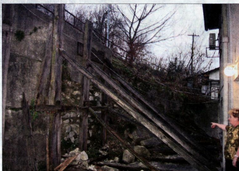
Zaradi podrtje lesene zaščite, ki je preprečevala podiranje opornega zidu, so zdaj v nevarnosti stanovanjski Trubarjeve ulice 23.
