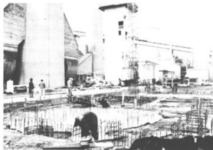
Z izgradnjo zaprtega krogotoka tehnoloških voda, TEŠ jezer in Pake ne bo več dodatno onesnaževal
