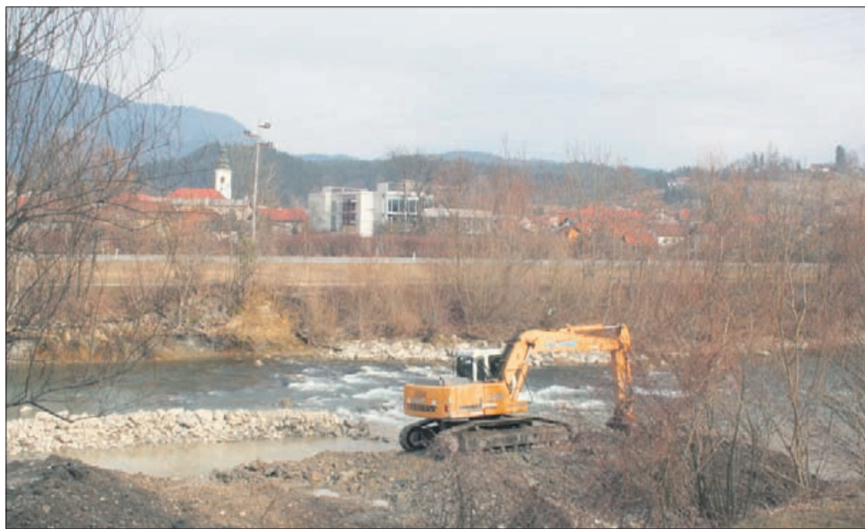
Med Mozirjani je slišati, da bo očiščeno korito Savinje služilo tudi domačim ribičem.
