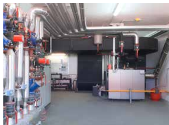
Kotlovnica v sanitarni
