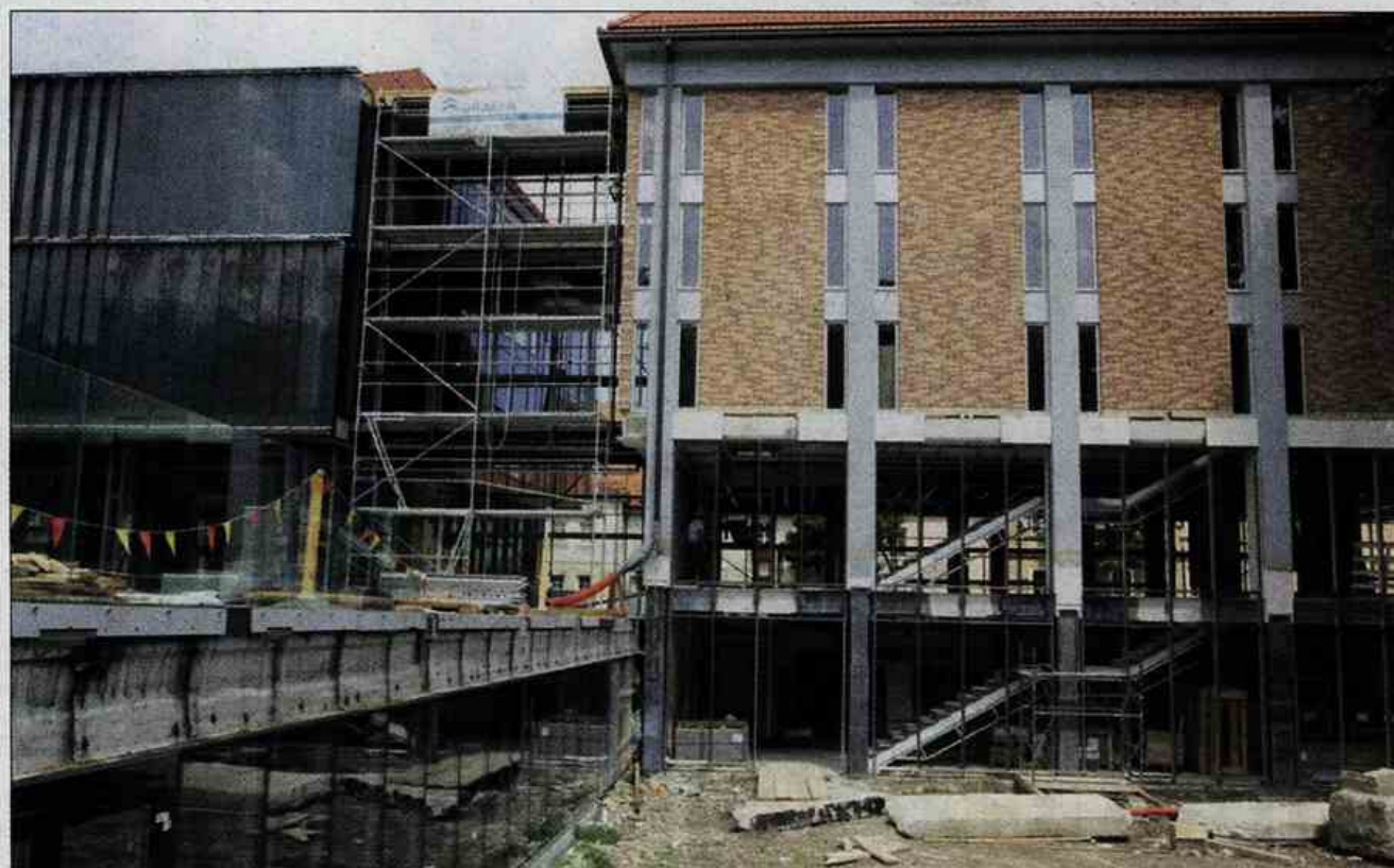
Prizorišče zadnje smrtne nesreče na gradbišču celjske knjižnice na Muzejskem trgu.
