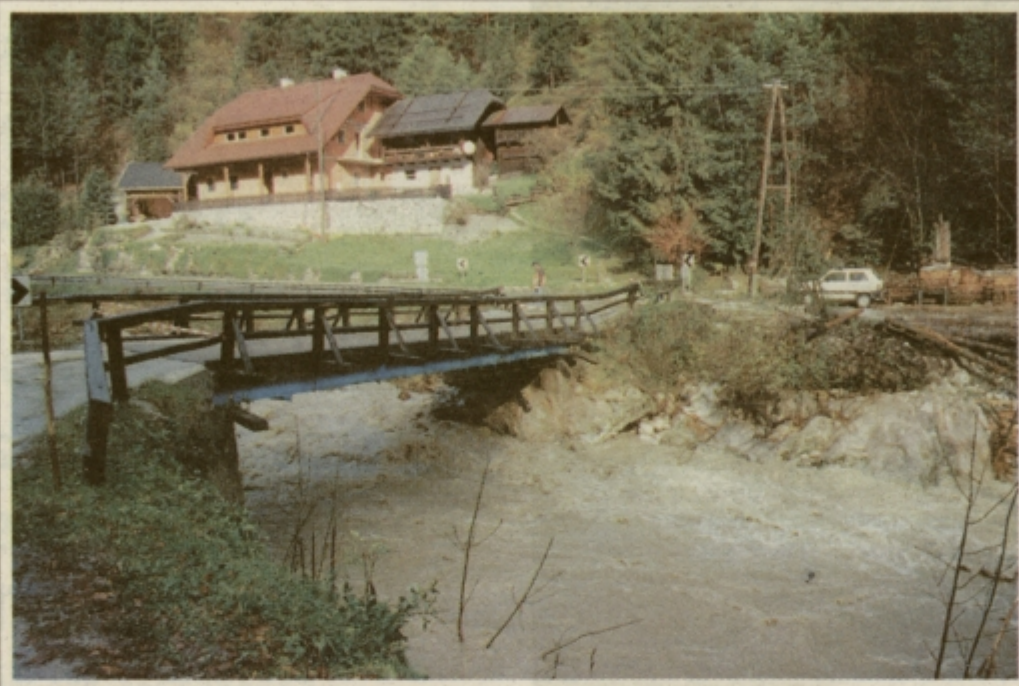
Narasla voda je tako poškodovala most pri Rogovilcu, da je vožnja preko njega prepovedana za vsa vozila.
