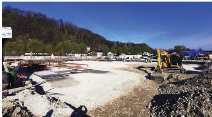
Geološko poročilo je zahtevalo zamenjavo zemljine, zato so najprej odstranili za okoli 3500 m 3 podlage in jo nadomestili z ustreznim materialom.
