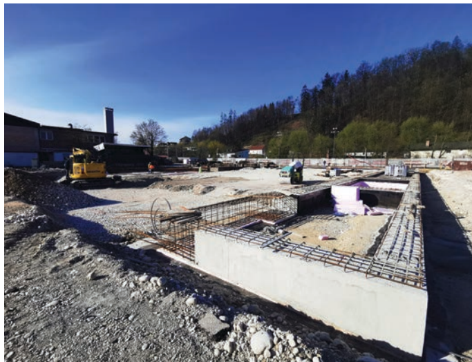
Z izdelavo pasovnih temeljev se vse bolj nakazuje tloris nove športne dvorane.
