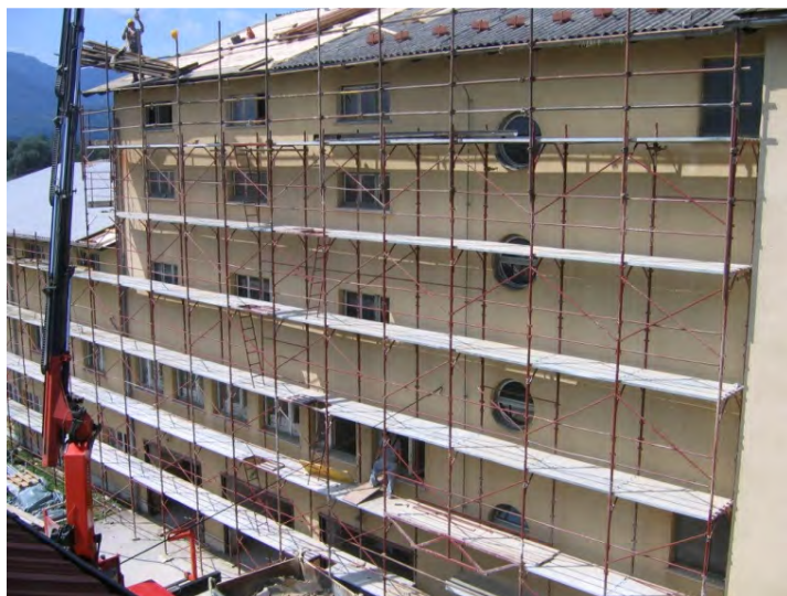
Menjava strehe, oken in barvanje fasade (foto: P. Bukovec in B. Čremožnik, tekst: M. Zupančič)
